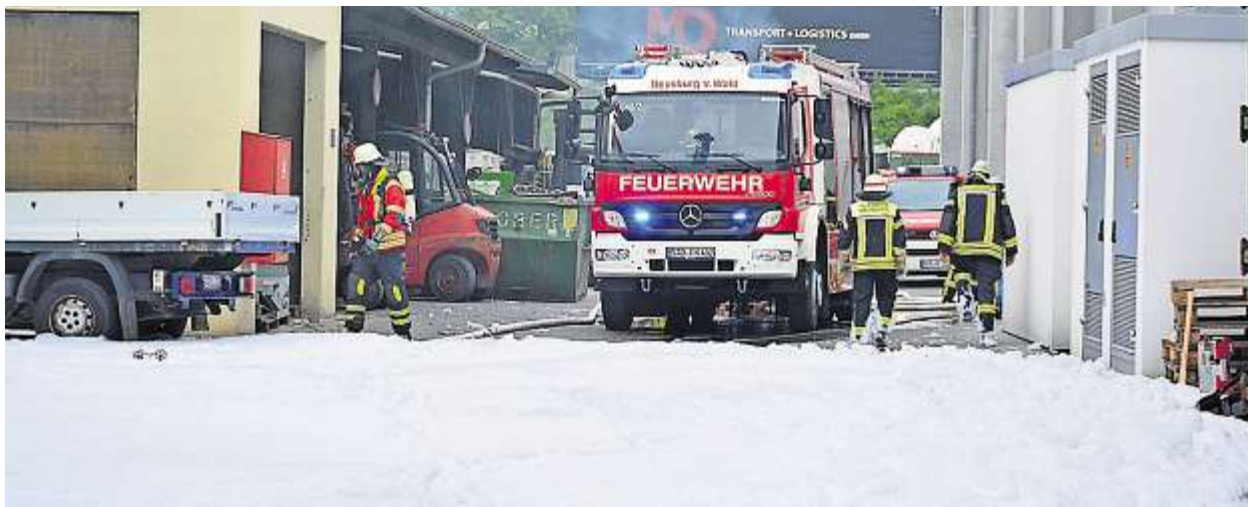
In einer Maschine zum Zerkleinern von Industrieschnittgut brach ein Feuer aus, das aber von der halleneigenen Schaumlöschanlage schnell eingedämmt werden konnte. Der Schaum auf dem Foto stammt aus der Anlage. FOTO: GGO
